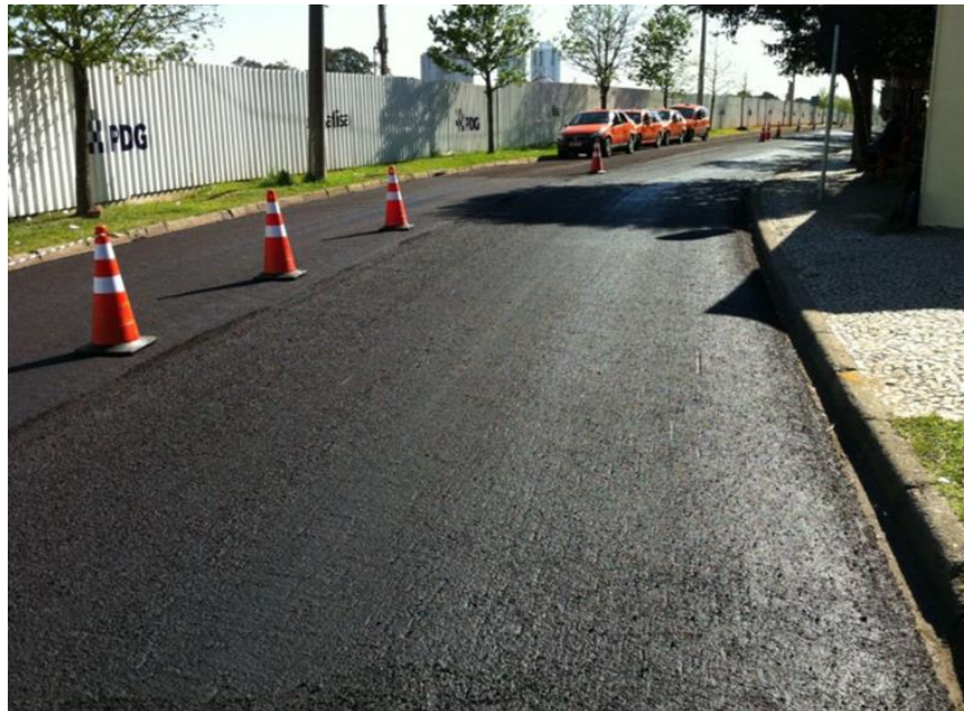
Figura 3 - Pavimentação com recapeamento em concreto asfáltico com ligante de borracha em Curitiba
