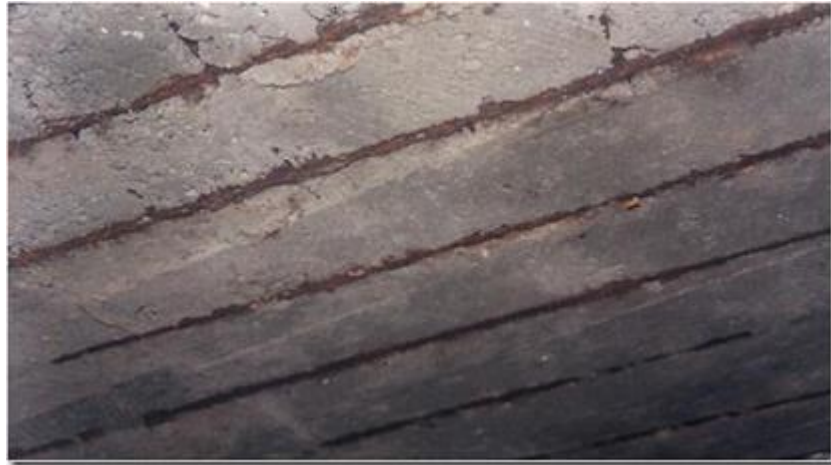
Figura 5: falha de cobertura da armadura.
