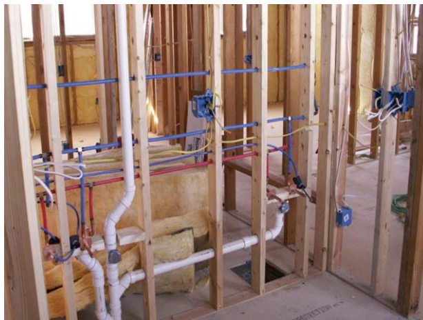
Figura 3: Sistema elétrico e hidráulico instalados.
